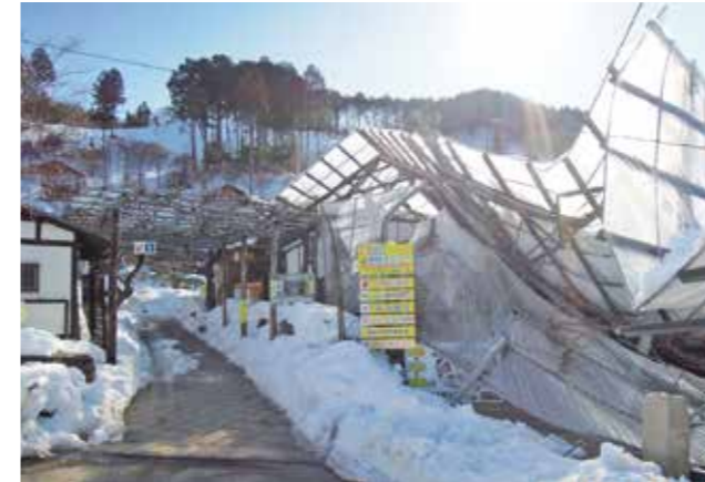
雪害で倒壊したイチゴハウス
