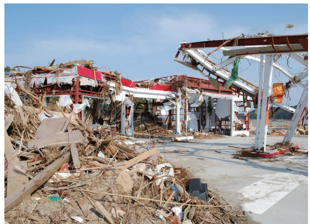
▲津波による被害を受けたJA南三陸GS 5月16日
