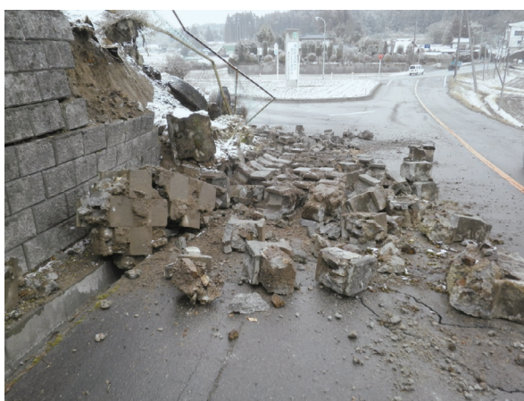
▲のり面が崩れ、路面も断裂した
